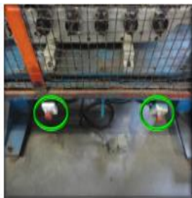
改善前：急停按钮外露
