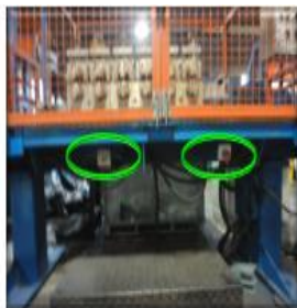
改善后：急停按钮移至设备内
